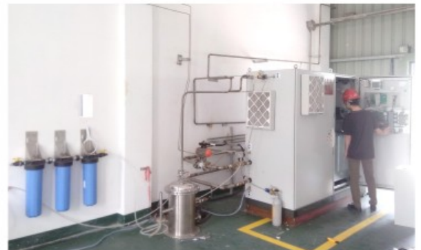
长兴电厂制氢机调试现场
